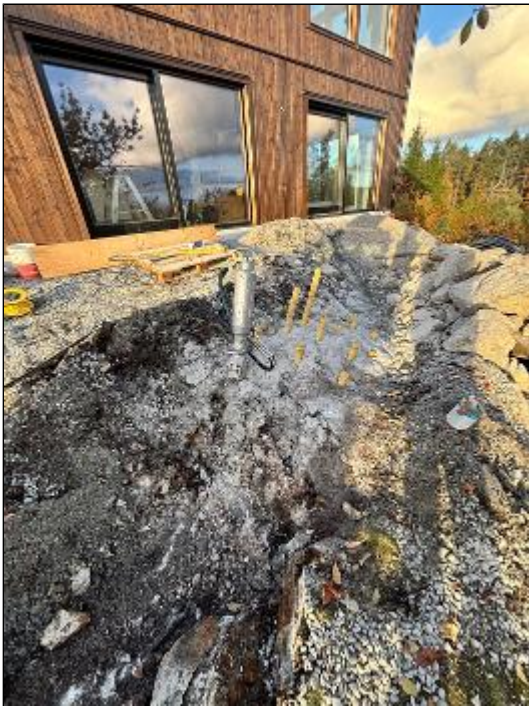
Borrt spräckt och rivit berg för avlopp vatten el fiber Monterat frigolitlåda med div rör fyllt med stenmjöl
