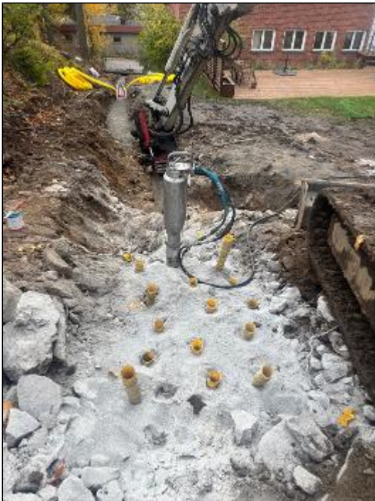
Borrat, spräckt och rivit för frigolitlåda rör för fiber el, vatten avlopp
