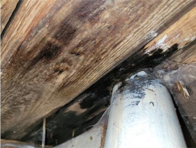
Läckage i yttertak
