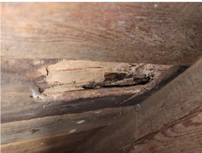
Spår från skadedjur på underlagstak
