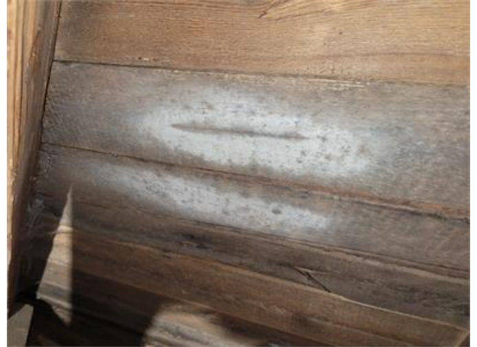
Mikrobiell påväxt på underlagstak
